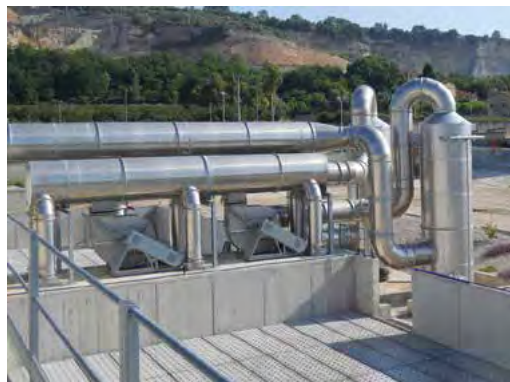
Biofiltro e scrubbers per trattamento odori
