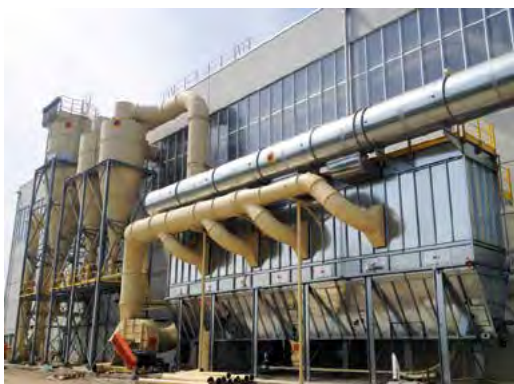
Impianto di aspirazione e filtrazione polveri
